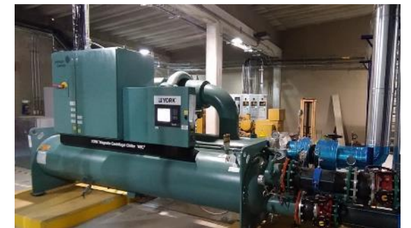
Ampliación de capacidad Central de Frío 2 - Nuevo Chiller 2 (I semestre)
